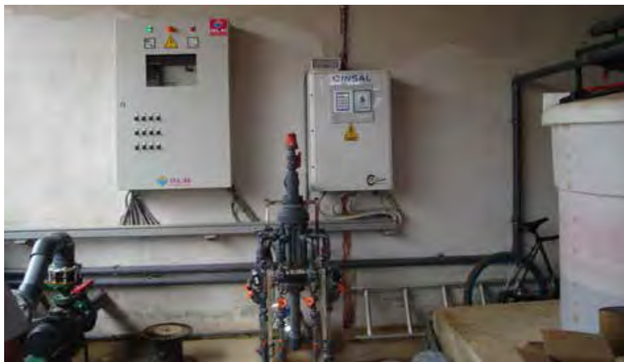
Figura 14. Sistema de fertirriego.
